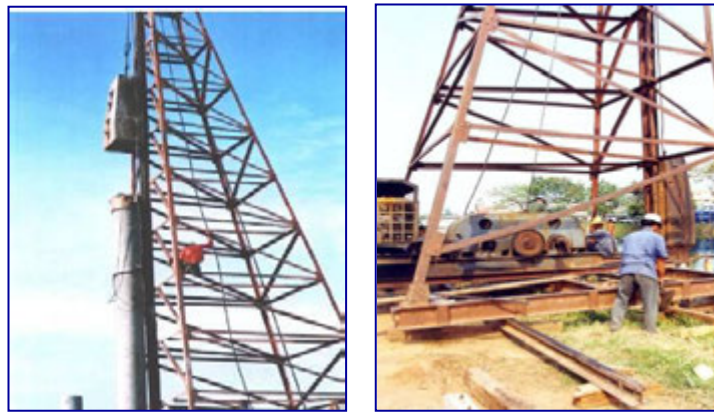
ตัวอย่างแสดงเครื่องตอกเสาเข็มและอุปกรณ์รางเลื่อน
