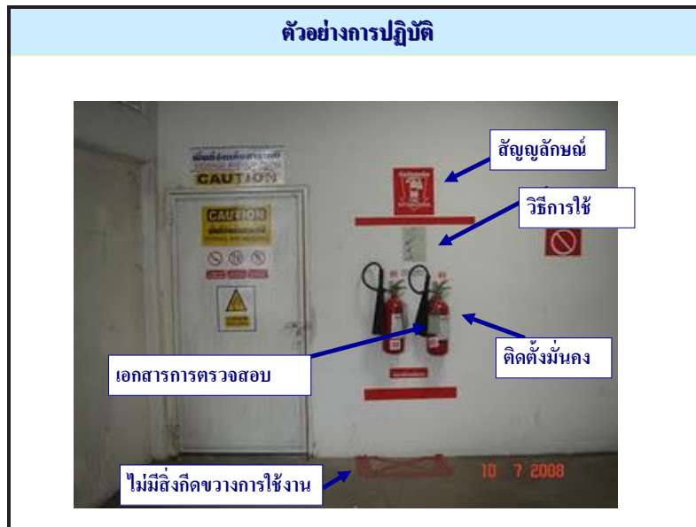
ตัวอย่างแสดงการติดตั้งเครื่องดับเพลิงแบบเคลื่อนย้ายได้
